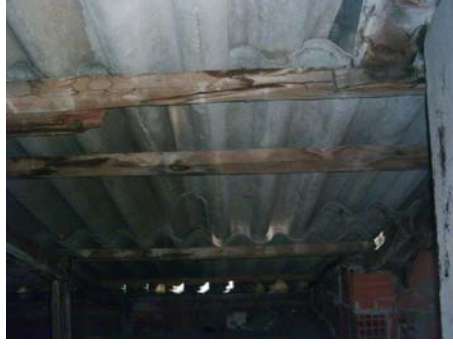
Resim 2.1: Detay Çözümleri Yanlıř Uygulanmıř Bir Kaplamadan Dolayı İçeriye Giren Yađmur Suyunun Çatı Tařıyıcısına Verdiđi Zarar
