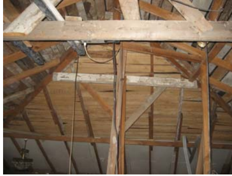
Resim 1.2: Çatı Taşıyıcı Sisteminde Oluşan Hasarlar
