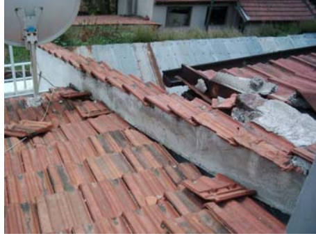
Resim 1.4: Hatalı Kiremit Çatı Uygulaması
