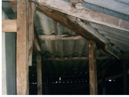
Resim 1.1: Çatı Taşıyıcı Sisteminde Oluşan Hasarlar
